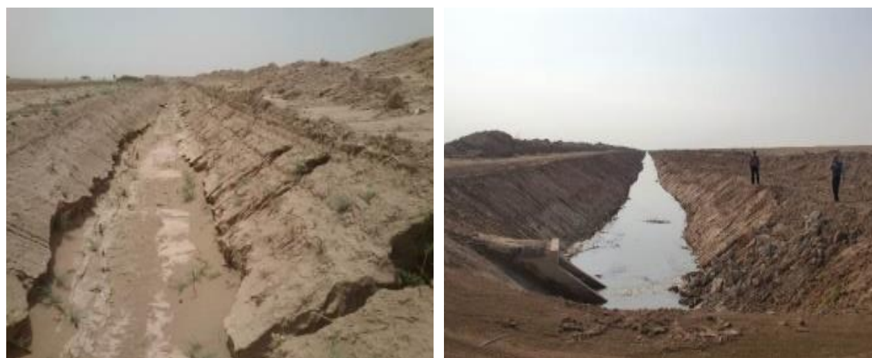
شکل ۲- فرسایش شیاری و پنجه‌ای به وجود آمده در دیواره کلکتور روباز Figure 2- Erosion of the groove created in the wall of the earthen channel
